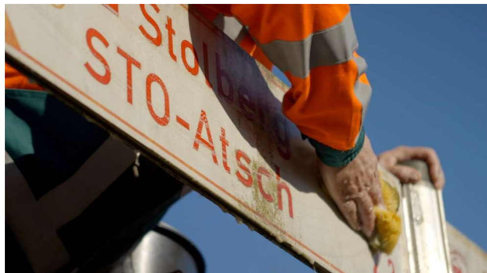
Abb. 6-6: Beseitigung von kleinen Mängel durch den Baulastträger (Quelle: WeishauptFilm)
